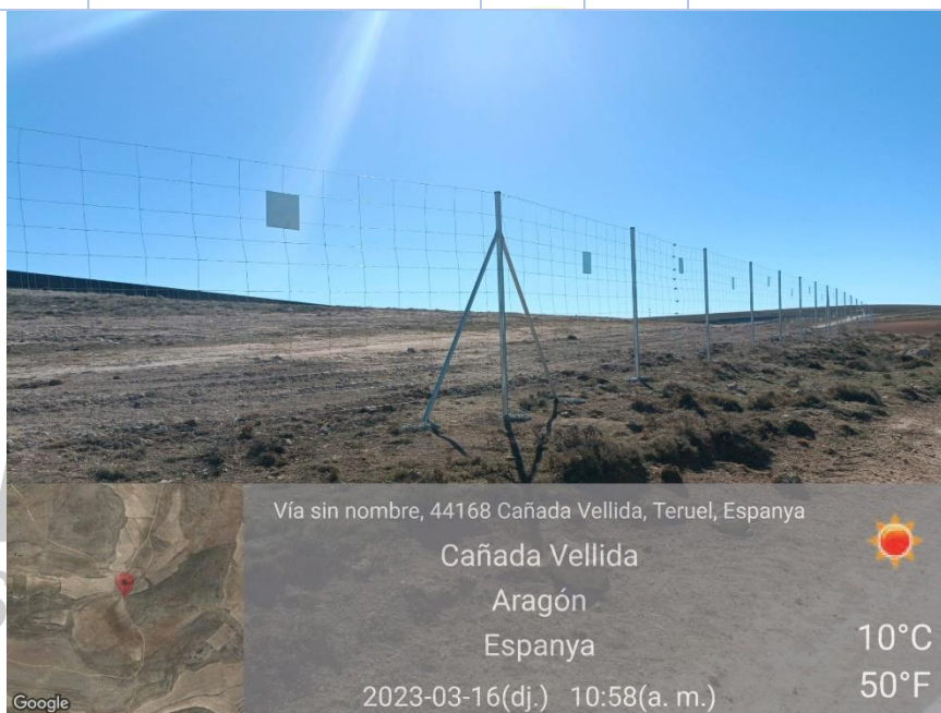
Ilustración 4. Placas anticollisión en el vallado
