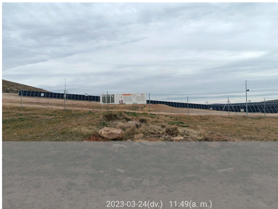
Ilustración 9. Centro de transformación de la zona 1
